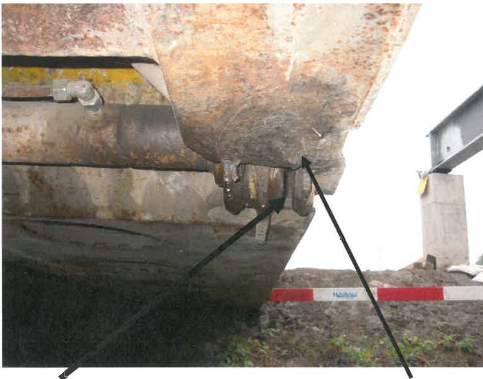
Bolzenverbindung in Brückenmitte Klaffung 2,0 cm
